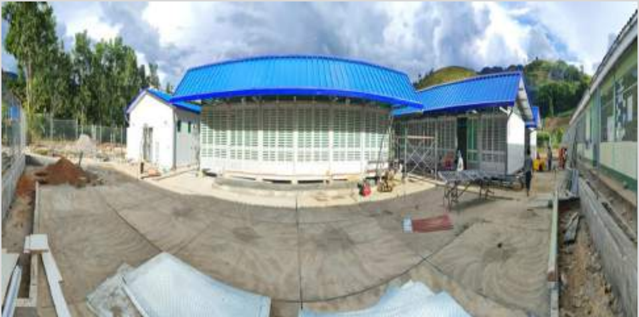
Descripción: Módulos instalados (24/04/2024)
