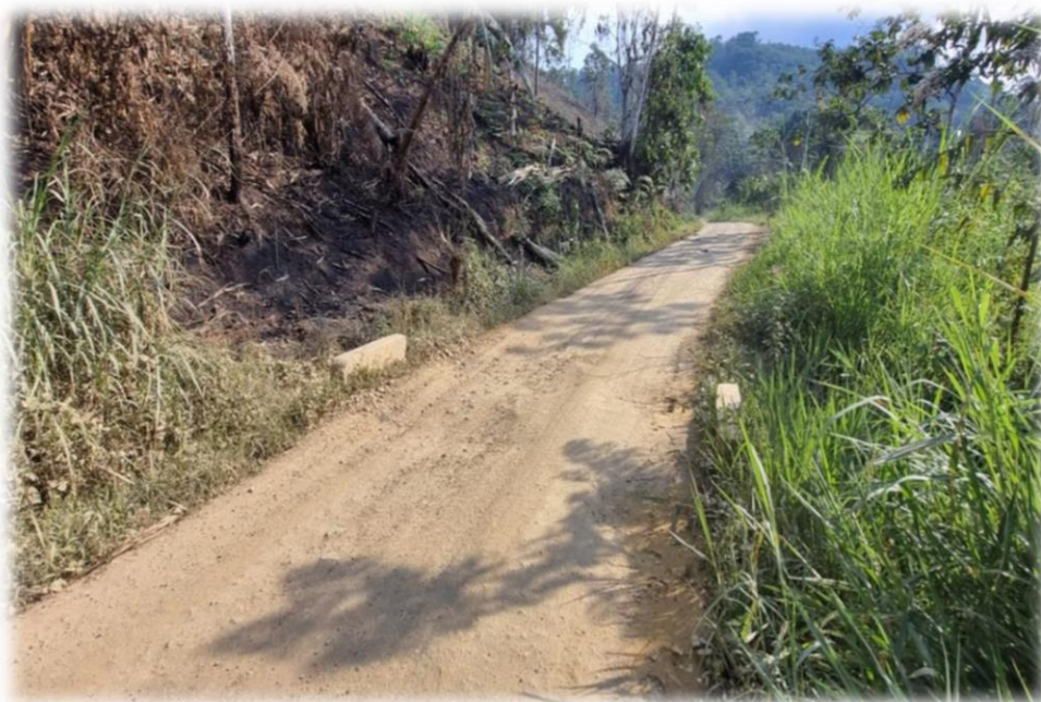
Estado actual de la via.
