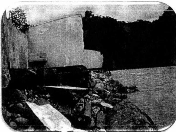
COMEDOR DESTRUIDO DEL BAT. ING. (E.P.) – LA MERCED
