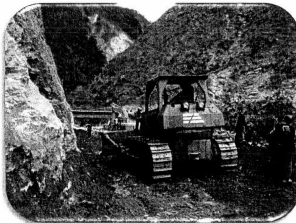
RIO MARANCOCHA CARRETERA CHIMAY-MARANCOCHA DESBORDE
