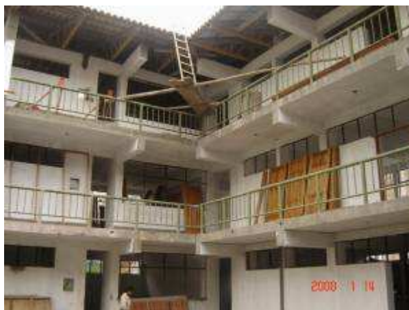
Fase final de la construcción y mejora de aulas de Institución Educativa.
